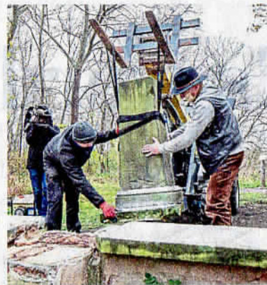
Die Eichendorff-Bank wurde am Dienstag abgebaut. FOTO: STADT HALLE/ZIEGLER
